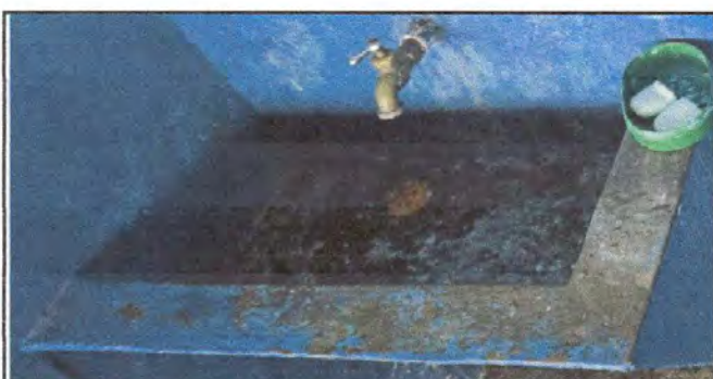
Foto 5: Sustrucción de grifos en lavamanos de servicios sanitarios.
