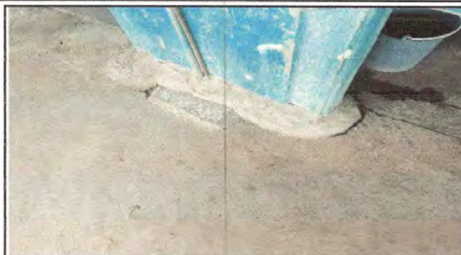
Foto 8: Sustrucción de torta de concreto en pila.
